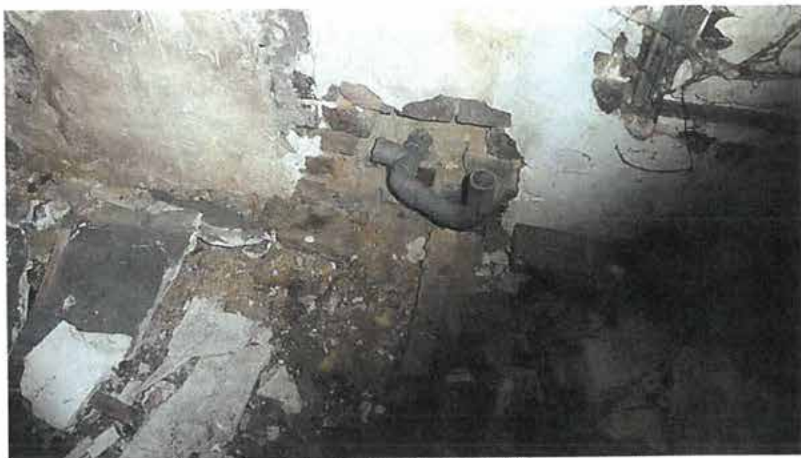
Plomberie d'évacuation en PVC
