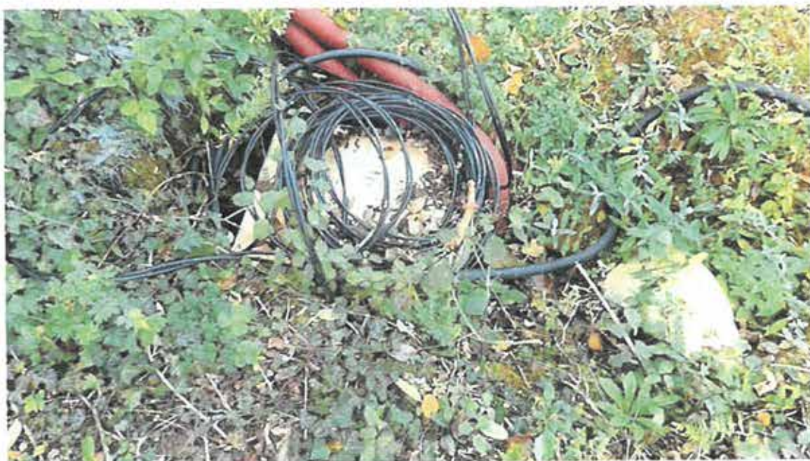
Alimentation en eau et électricité
