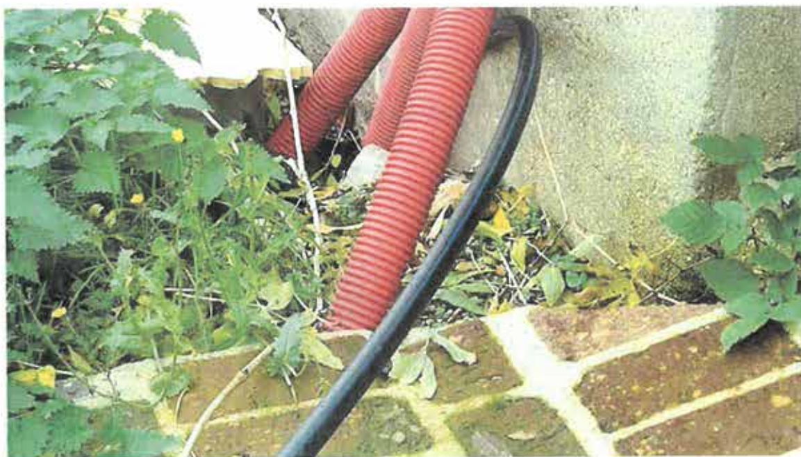
Alimentation en eau et électricité
