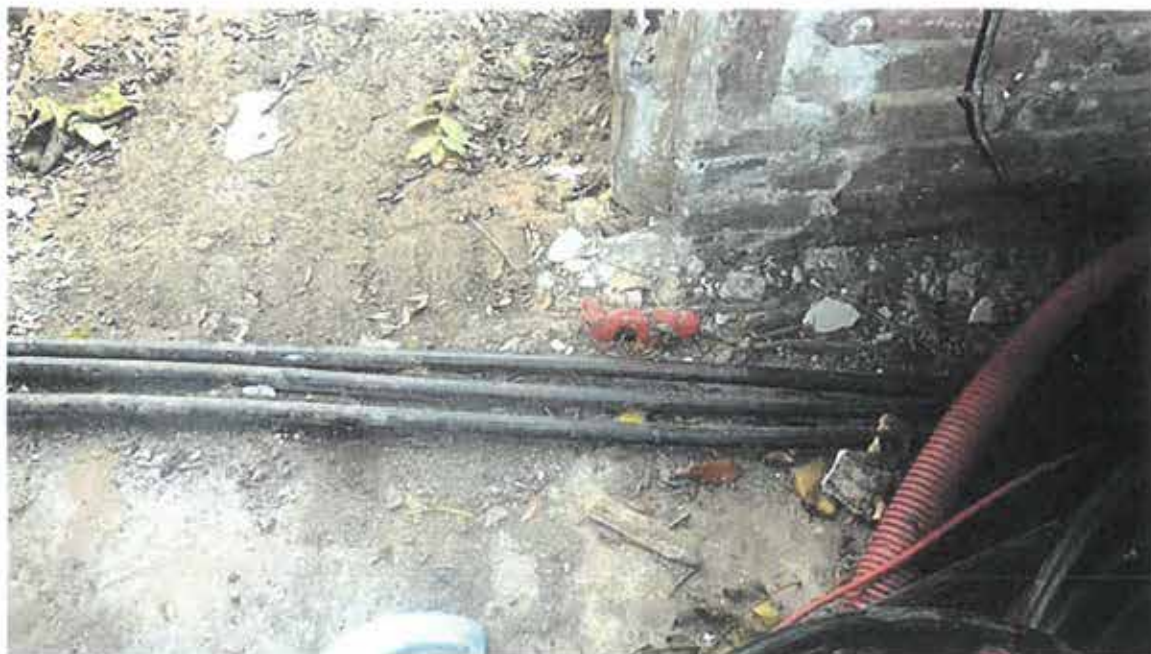
Alimentation en eau et électricité
