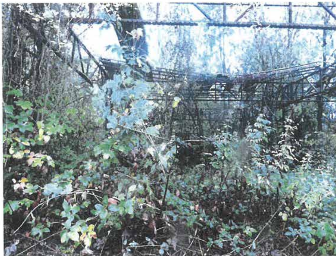
8- HANGAR EN MAUVAIS ETAT DE 460 M2
