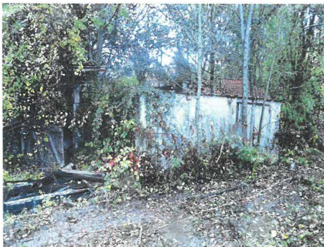
6- BATIMENT SURFACE 120M2 EN MAUVAIS ETAT EN BRIQUES COUVERTURE EN TILES
