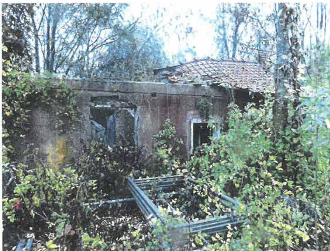
7- BATIMENT DE 140M2 MAUVAIS ETAT EN BRIQUES COUVERTURE EN TUILES
