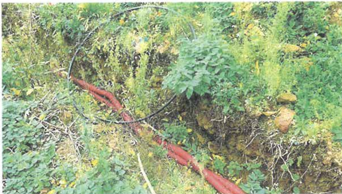
Alimentation en eau et électricité
